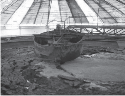
写真7 汚泥乾燥処理
