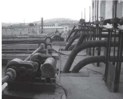
写真6 老朽化が目立つ機械設備
